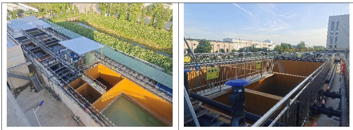
图4.1-3 项目废水治理设施图片
