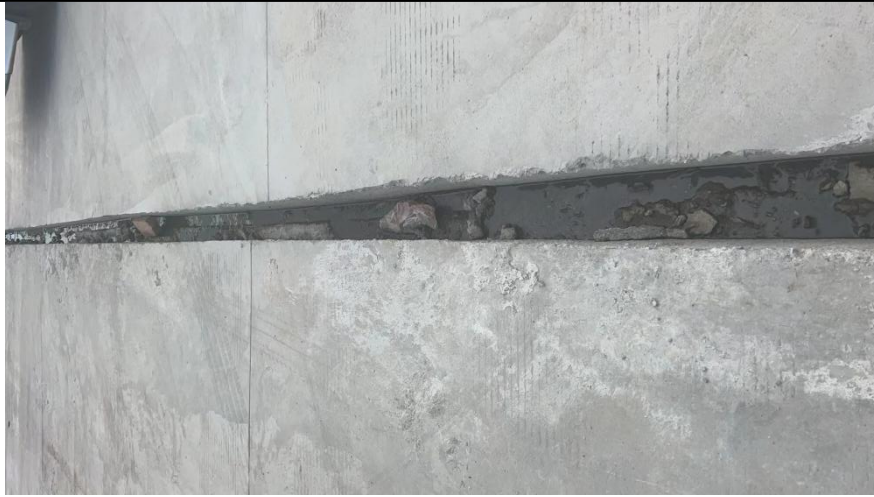
图 7 厂区内雨水收集槽
