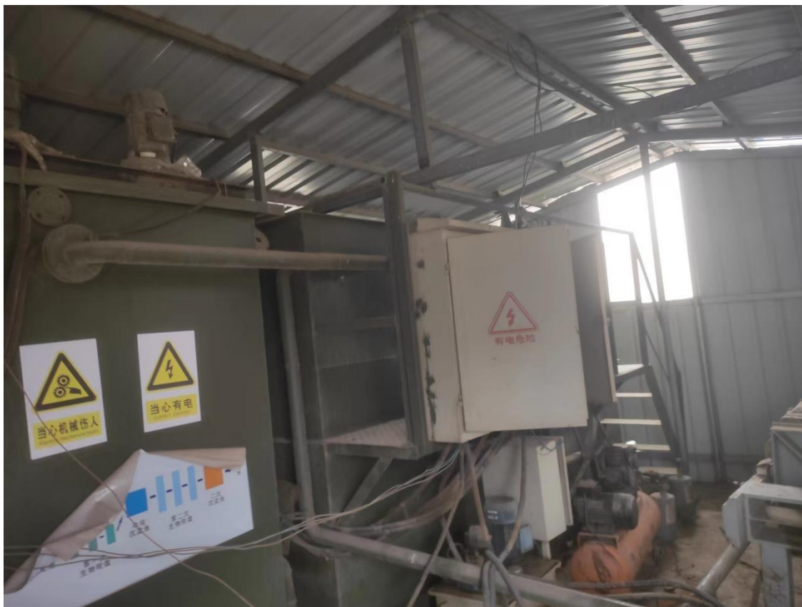
图 6 厂区内污水处理站
