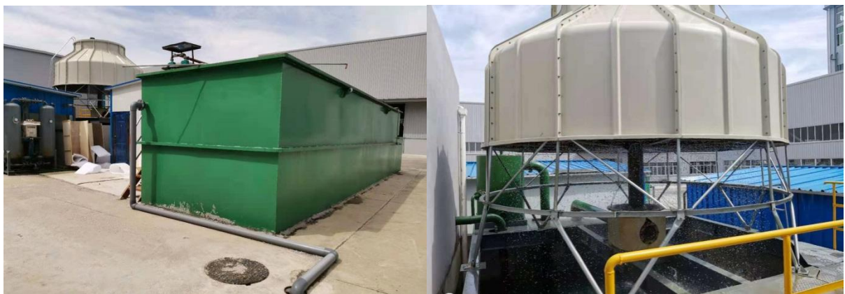
图 7 生产废水处理装置
