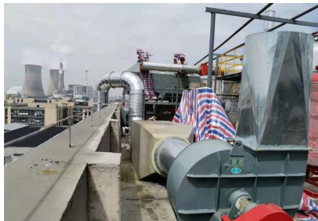
图 8 TA001+DA001 排气筒装置
