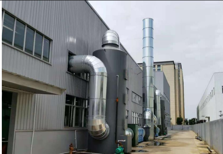
图 9 TA002+DA002 排气筒装置
